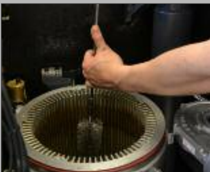
Wärmetauscher mit Bürste reinigen
