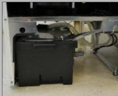
Siphon, Neutralisation und Kondensatpumpe reinigen
