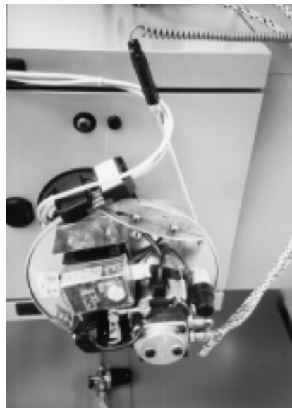
Рис. 6: Измерение температуры воздуха для поддержания процесса горения у отверстия горелки
